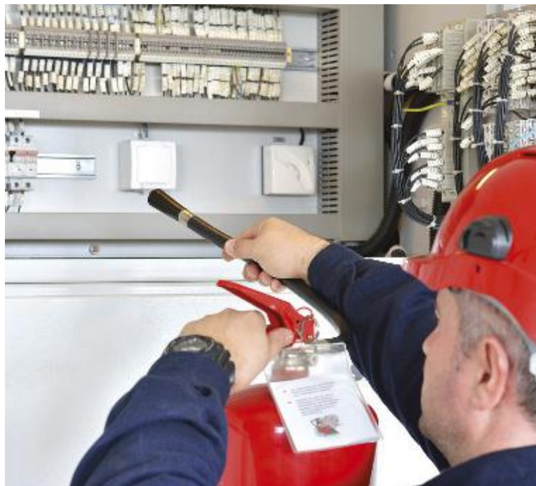
↑ Tra gli impianti in condominio, l'impianto elettrico è tra i più importanti
