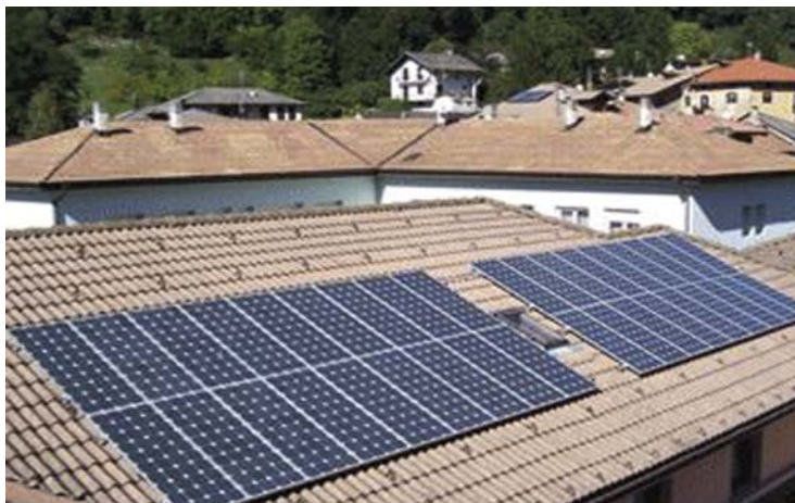
FOTOVOLTAICO A TETTO
